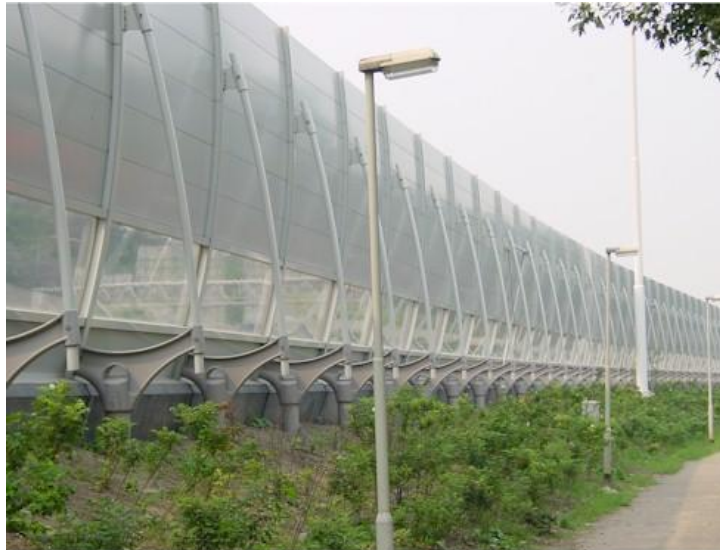
Рис. 3. Шумозахисні споруди напівпрозорі
