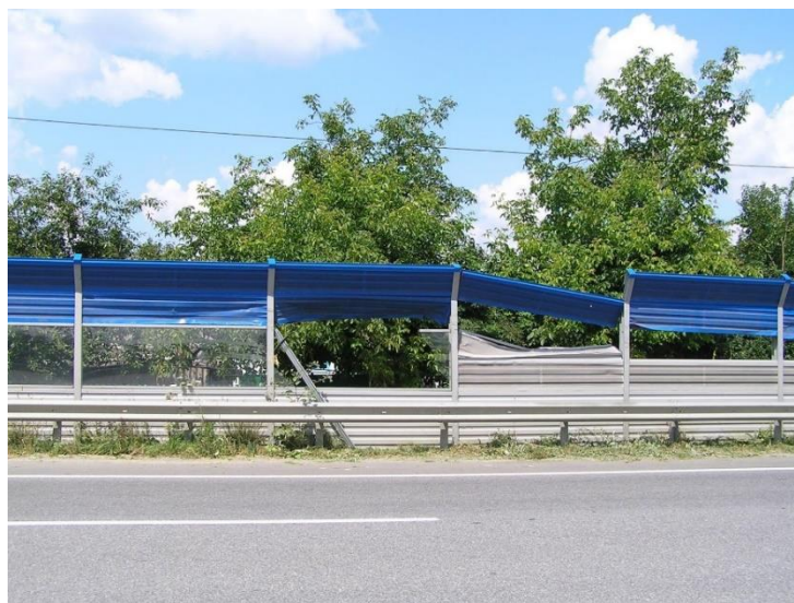
Рис. 7. До неправильного встановлення шумозахисних екранів (поламки від довгобазових автомобілів, що розвертаються)
